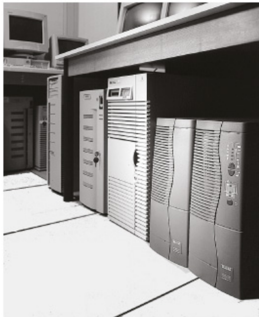
Fig. N32 – Unidad UPS logrando disponibilidad y calidad de suministro de energía del sistema informático
